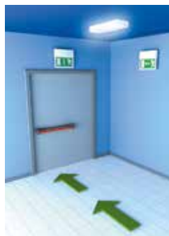
Sulle uscite di sicurezza ed in corrispondenza dei segnali di sicurezza.
