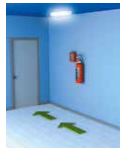
Vicino ad ogni dispositivo antincendio e punto di chiamata.
