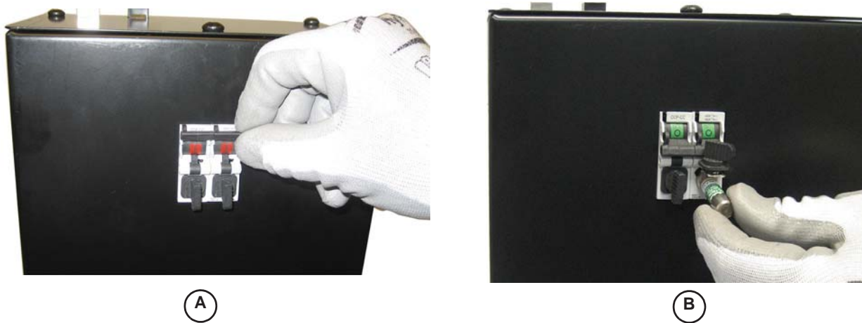
Figura 16: Sustitución de fusibles en el desconectador con fusible en la unidad PBPEGX
