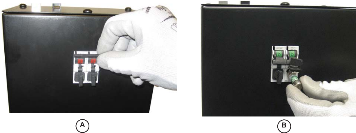
Figure 16 : Remplacement des fusibles du sectionneur à fusibles sur l'unité PBPEGX
