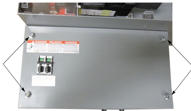
Figure / Figura / Figure 5 : Removing Cover of Communications Box / Extracción de la cubierta de la caja de comunicaciones / Retrait du couvercle du boîtier de communication
