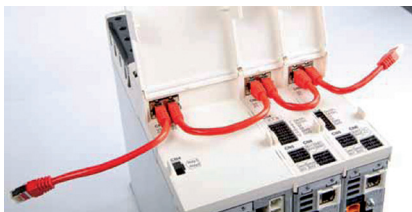
Connexion au réseau Sercos
