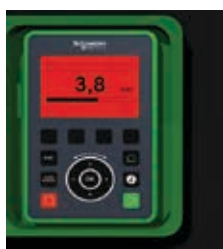
Fallo detectado: La retroiluminación roja de la pantalla se activa automáticamente
