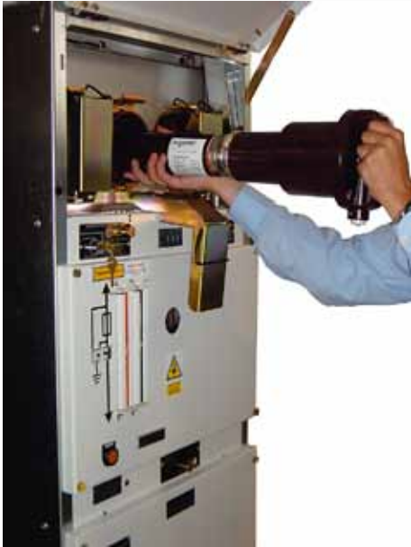
Fusarc CF instalados en una celda CAS 36
