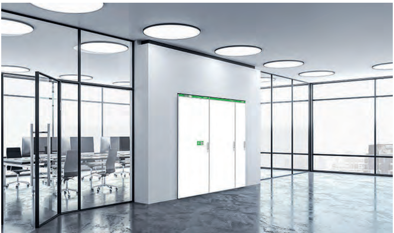
Passerelle sans fil (Panel Server) Prisma SeT Active installé dans son environnement
