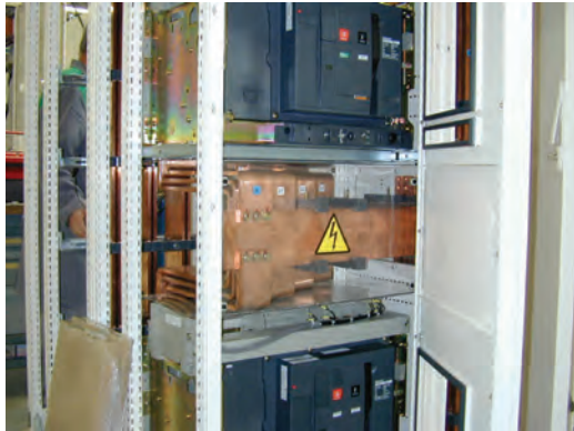
Système de changement de source dans la même armoire.
