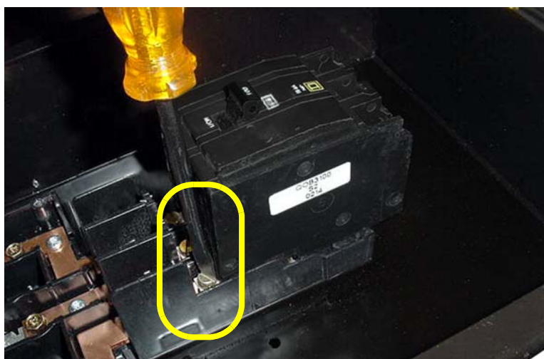
Figure 40 : Retrait du disjoncteur QOB
