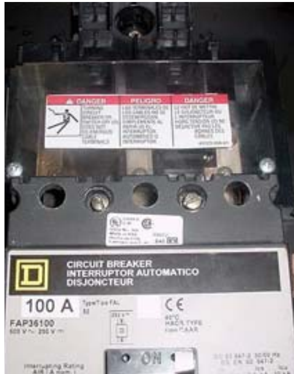
Figure 4 : Pose de l'étiquette pour rétro-alimentation (disjoncteur)
