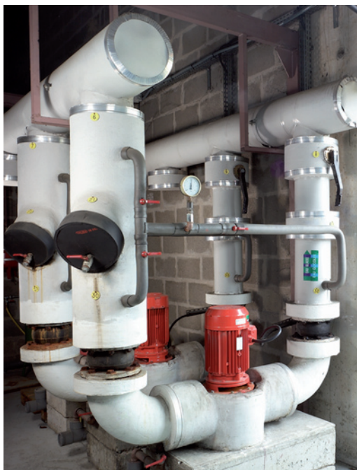
Exemple d'utilisation du démarreur-ralentisseur Altistart 22 pour une application avec pompe
