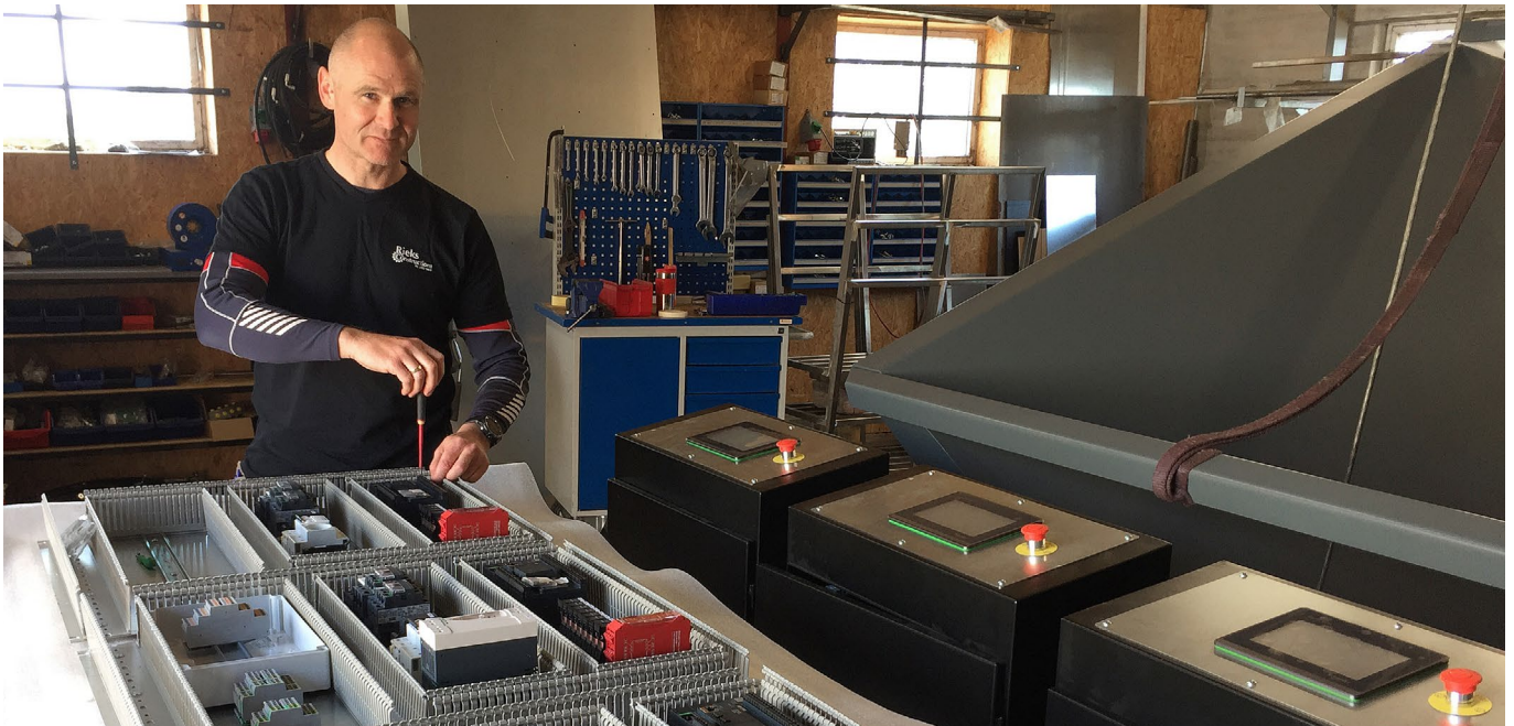
Rieks Construction har blandt andet implementeret PLC, HMI og sikkerheds-controller fra Schneider Electric i deres maskiner.
