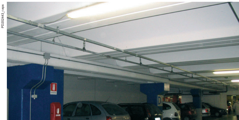
Canalis KBA alimentant des luminaires à proximité des sprinklers.
