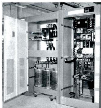
transformateur de séparation des circuits BT et différentes possibilités d'équipement
