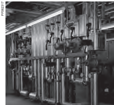
Steuerung einer Pumpenstation mit ATV 12
