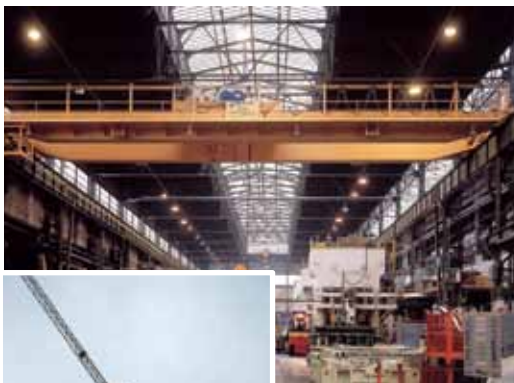
Laufkran in Pressenwerkstatt
