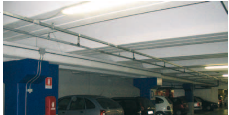
Canalis KBA, welches Leuchten in der Nähe von Sprinklern speist.
