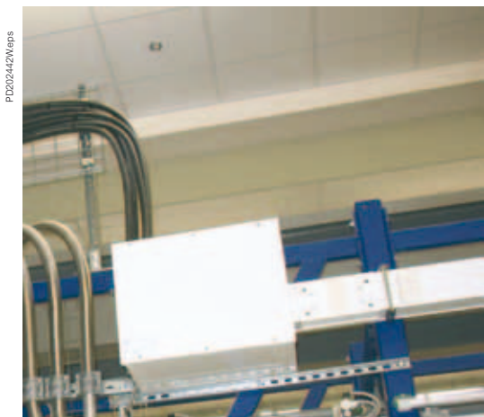
Canalis KS und Sprinkler.
