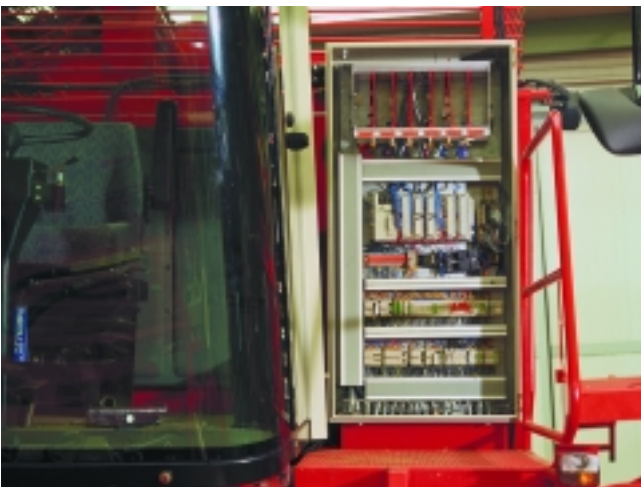
Zicht op de binnenkant van de kast, gemonteerd naast de cabine
