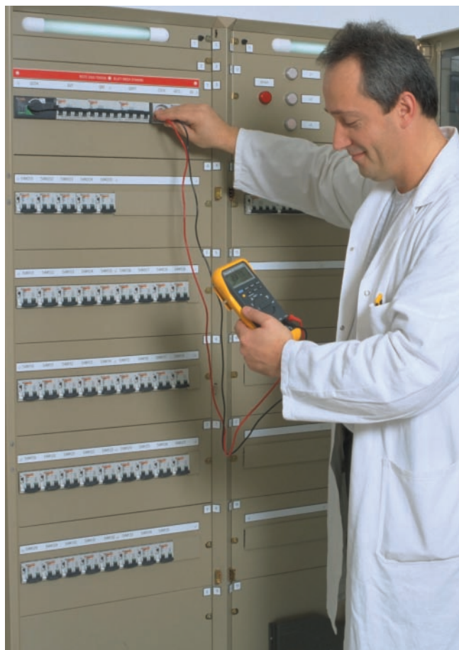
Prisma-verdeelbord uitgerust met vermogenschakelaars C60N.
