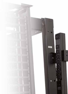
AR8652 in der rechten hinteren Ecke eines 4-Pfosten-Racks mit Rack-PDU
