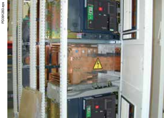
Sistema de inversor de rede na mesma cela.
