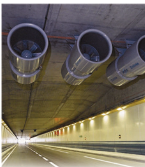
Extraction de fumée pour un tunnel
