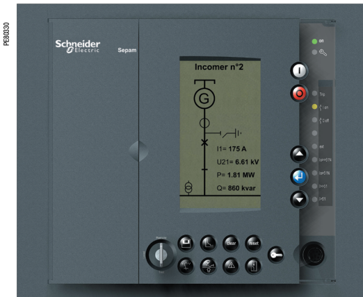
Режим местного управления выключателями с помощью графического UMI
