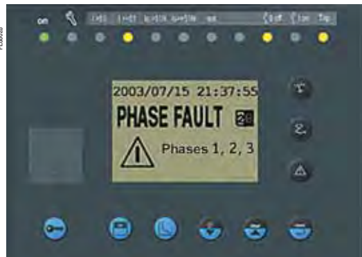
Сигнализация на передней панели Seram при местном управлении
