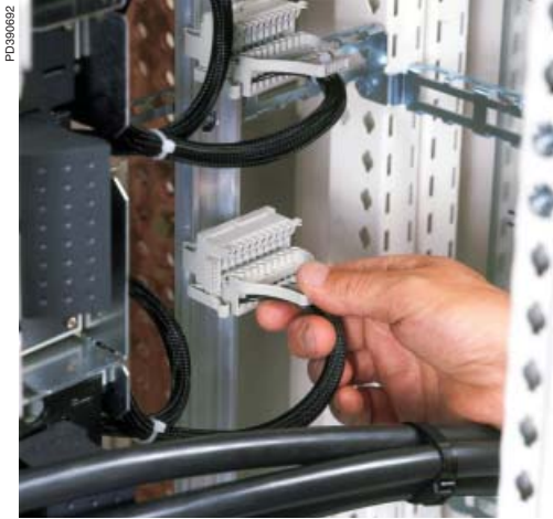
Kiegészítő csatlakozóblokk a kábelcsatlakozó térben.
