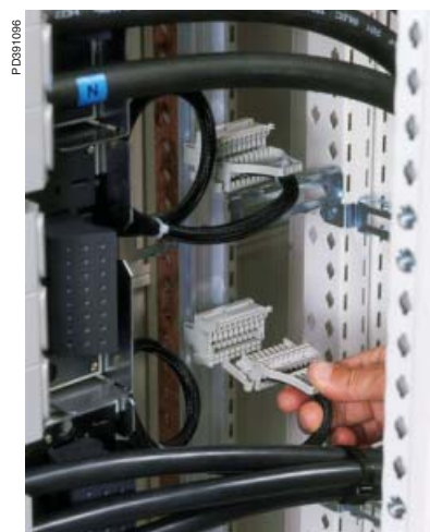
A csatlakozótérben elhelyezett segédáramkört csatlakozóblokk.
