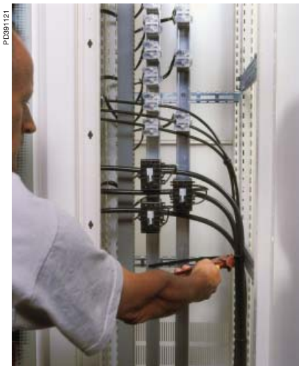
Melső csatlakozás hozzáférhető térrészben.
