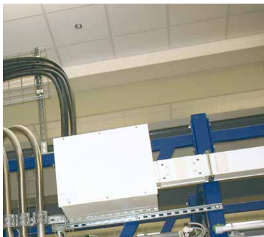
Canalis KS e sprinkler.
