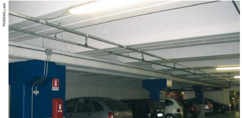
Condotti sbarre Canalys KBA con lampade e sprinkler.
