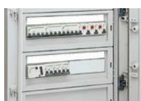
Dettaglio del sistema di identificazione dei circuiti.
