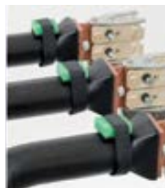
Supervisión de temperatura de las conexiones
