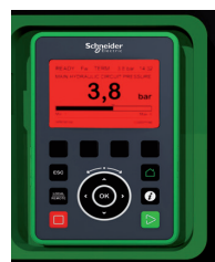
Défaut détecté : écran rouge en cas de détection d'erreur
