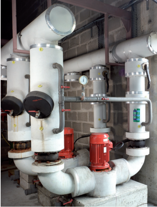
Exemple d'utilisation du démarreur-ralentisseur Altistart 22 pour une application avec pompe
