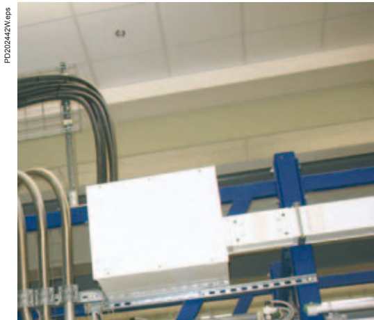
Canalis KS et sprinkler.
