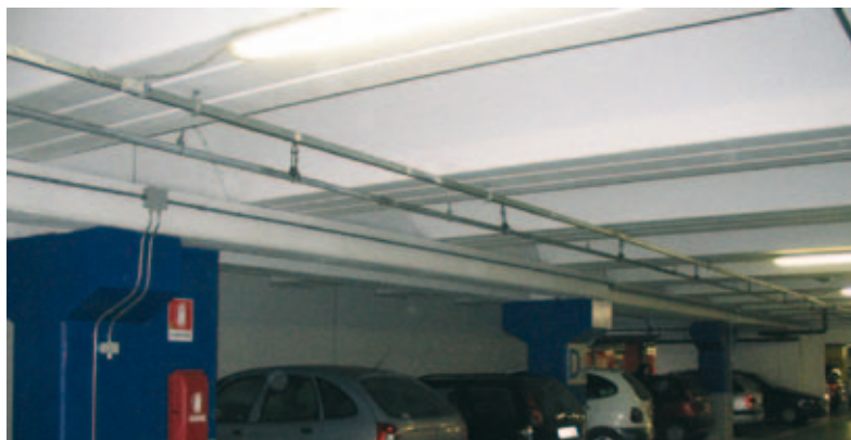
Canalis KBA alimentant des luminaires à proximité des sprinklers.
