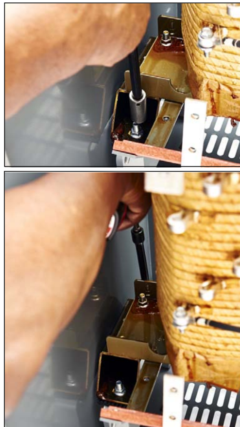
Figura 27: Gabinete estilo K: Tornillos accesibles desde la parte delantera del transformador
