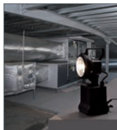
Fonction d'éclairage d'urgence
