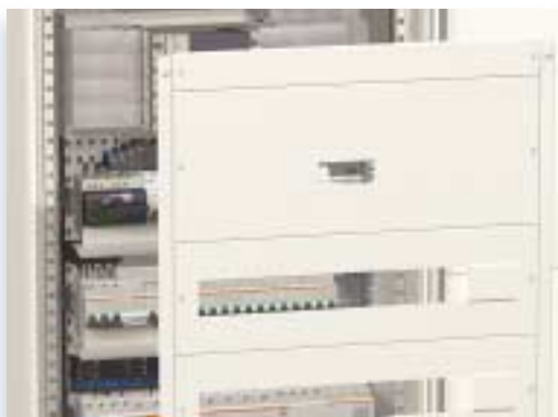
Las tapas ofrecen un acceso seguro a las manetas de los aparatos.
