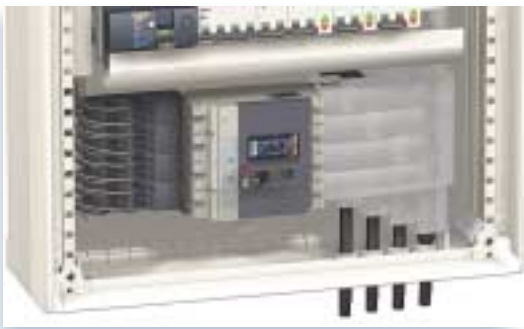
Bloques de conexión para cables de llegada con pantalla aislante (Llegada de los cables por la parte inferior).
