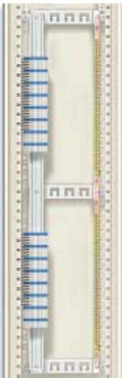
Bornero de conexión y colector de tierra en pasillo lateral.
