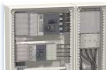
Bloques de alimentación de 630 A y 250 A aguas arriba y aguas abajo del juego de barras Powerclip.
