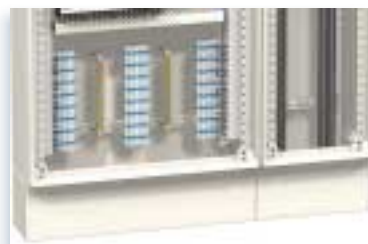
Bornero de conexión y colector de tierra en fondo de armario.
