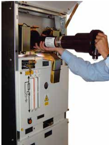
Fusibles Fusarc CF installés dans une cellule CAS 36
