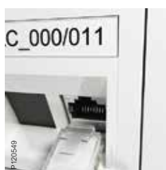
Plant, vinklat uttag för ett eller två nätverksjack.
