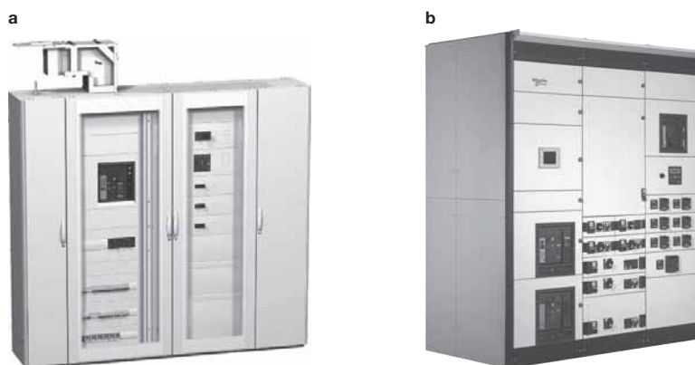
Fig. E47: [a] Un cuadro de distribución general de baja tensión, o CGBT (Prisma Plus P) con circuitos entrantes en forma de canalizaciones eléctricas. [b] Un centro de control de motores de baja tensión, o MCC (Okken).
