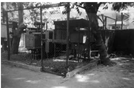
Fig. B36: Subestación de exterior.
