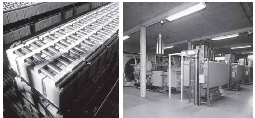
Fig. E18: Ejemplos de fuentes de alimentación de reserva: acumulador central (izquierda) y generador diesel (derecha).
