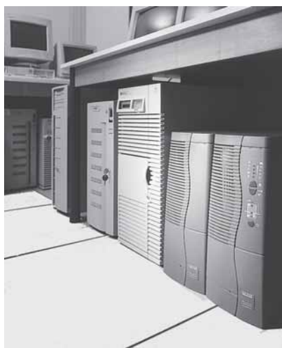
Fig. N30b: Unidad SAI logrando disponibilidad y calidad del suministro eléctrico del sistema informático.
