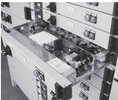
Fig. E52: Cuadro de distribución con unidades funcionales extraíbles en cajones.
