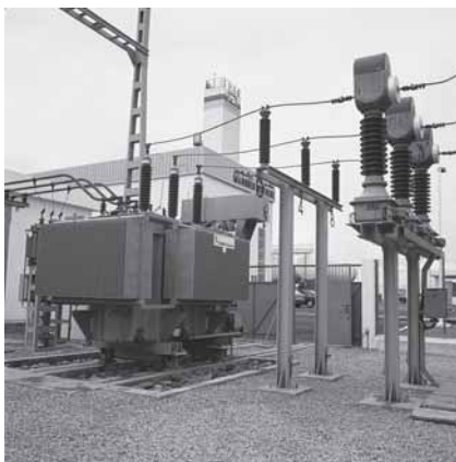
Fig. B25: Transformador con depósito de expansión.
