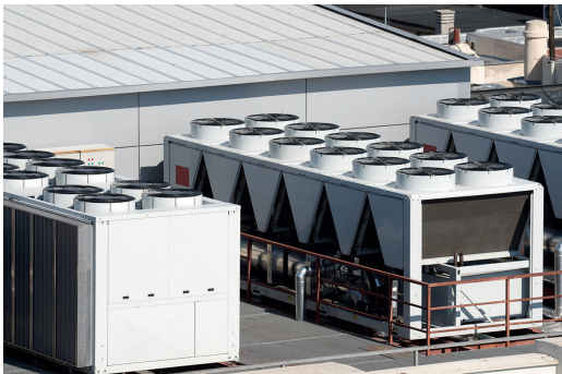
Groupe de production d'eau glacée
