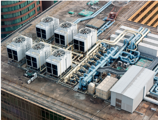
Climatisation et ventilation (HVAC)
