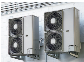
Pompe à chaleur
