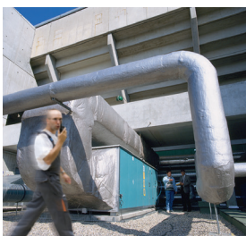
Centrale de traitement d'air,
